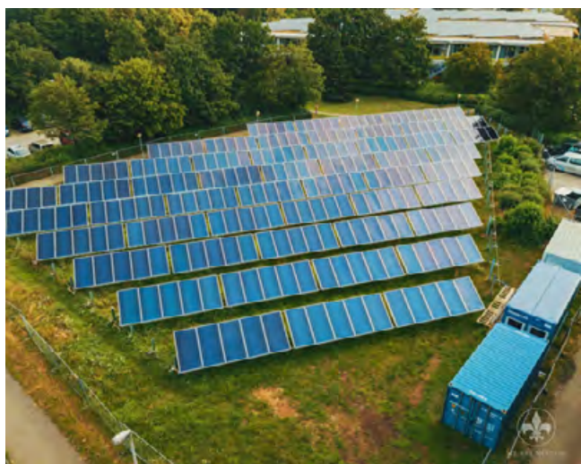
Aufgeständerte Solarthermiekollektoren auf der Grünfläche vor dem Gewerblichen Bildungszentrum (GBZ)
