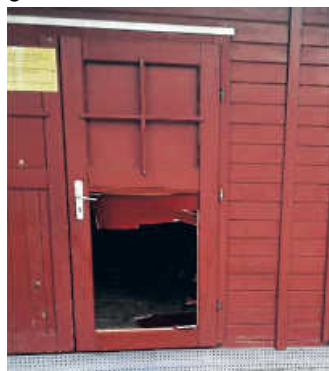
Das aufgebrochene Gerätehaus Foto: A. Kikillus
