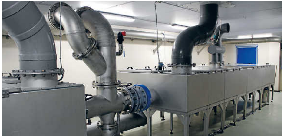
Über Flachbettbelüfter wird Luft eingeblasen und so die im Wasser befindliche Kohlensäure ausgetrieben Foto: tw/SWB
