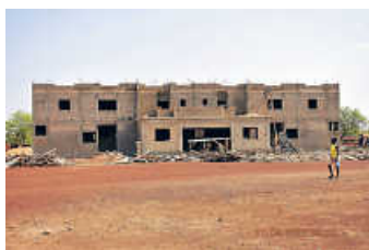
Krankenhausbau in Afrika: Außen Rohbau, innen sind die Wände schon verputzt, bei Türen, Fenstern und Dach gibt es Lieferprobleme Foto: Stéphane Souli
