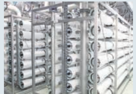
Die Bruchsaler in der Kernstadt sowie den Ortsteilen Ober- und Untergrombach werden seit Ende 2013 mit weichem Wasser aus der zentralen Teilentsalzanlage nach dem Umkehrosmoseprinzip versorgt. Foto: tw
