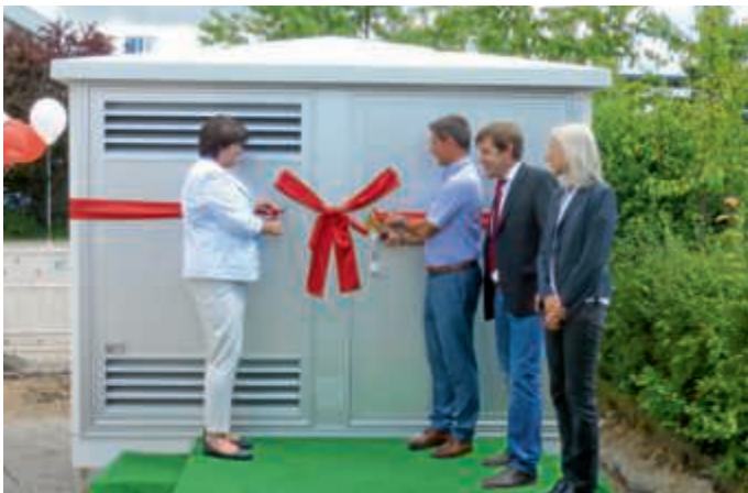
Neue Trafostation von Techpharm, Stadt Bruchsal und EWB offiziell in Betrieb genommen Foto: PM
