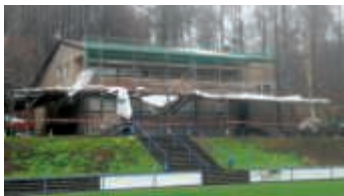
Schwere Schäden am Vereinsgebäude Foto: FC Alemannia 1929 Obergrombach
