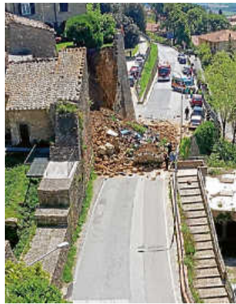
Mauereinsturz bei San Felice Foto: Stadt Volterra
