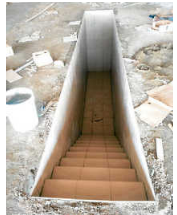
Die Lehrwerkstatt bekam auch einen gefliesten Schacht für Überkopf-Reparaturen Foto: M. Oubda
